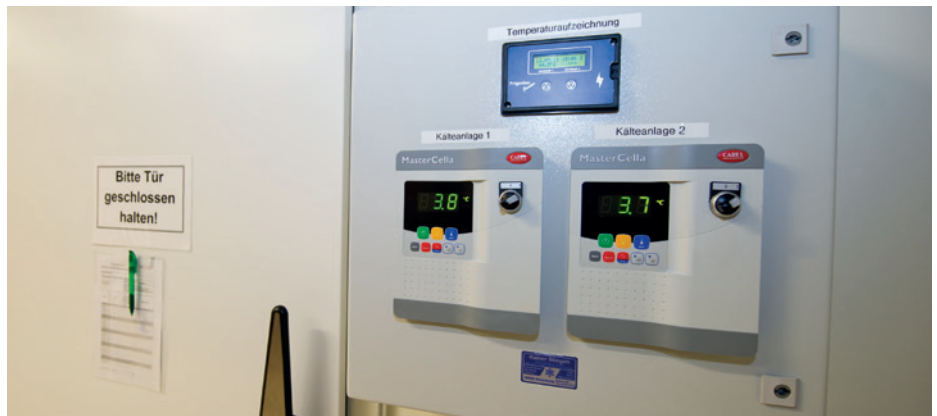
Alles unter Kontrolle: Aggregatoren zeigen die gemessene Innentemperatur der Kühlzelle außen an.
