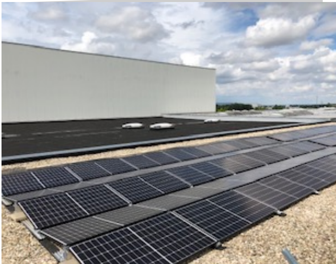
Photovoltaik-Anlage auf dem Dach des neuen BtM-Lagers
