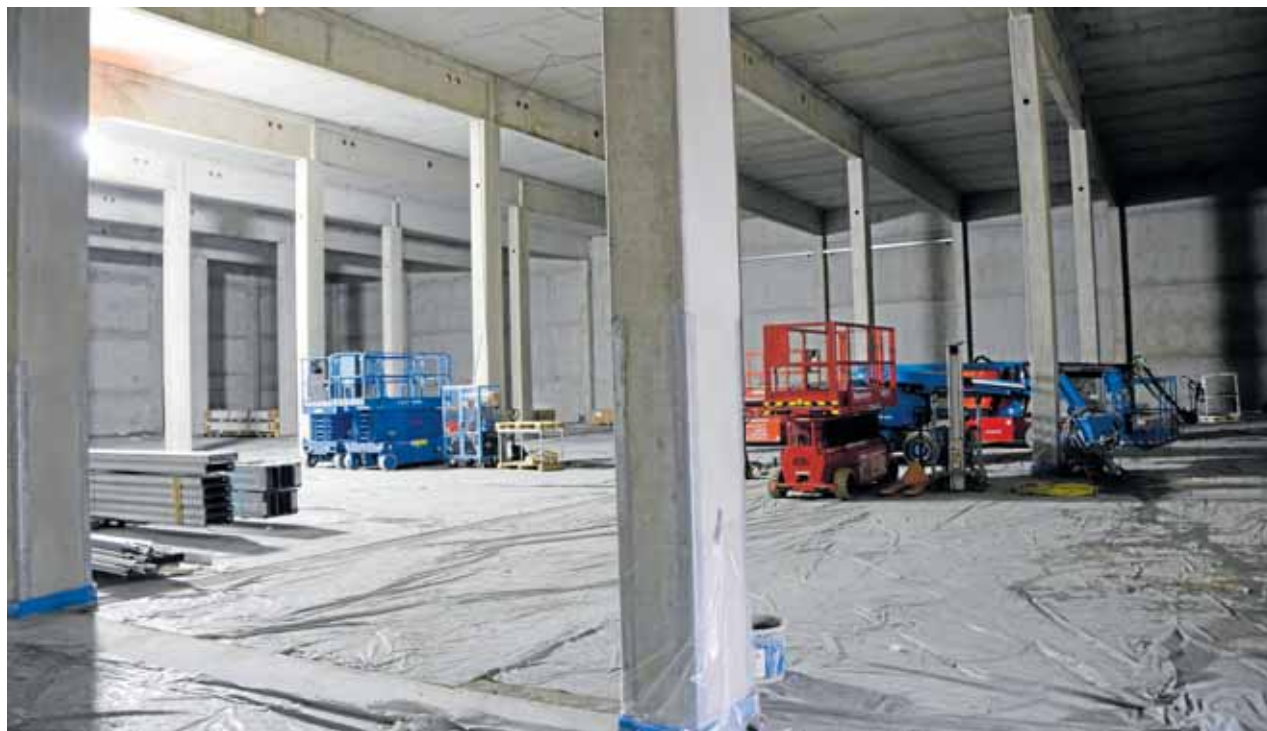
Blick ins Innere der neuen Lagerhalle von Med-X-Press: Noch steht der nackte Beton, vom Frühjahr 2022 an sollen hier 4000 Stellplätze für Medikamente bereit sein.
